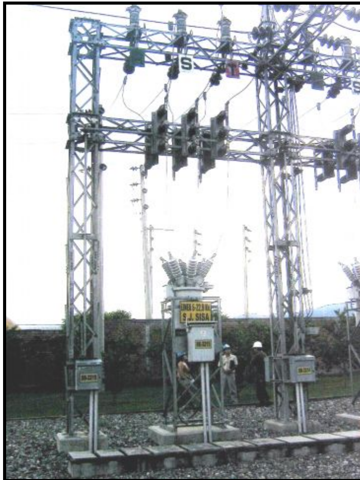
Foto 1: Salida 5 en 22.9kV (San José de Sisa) de la SE Bellavista
