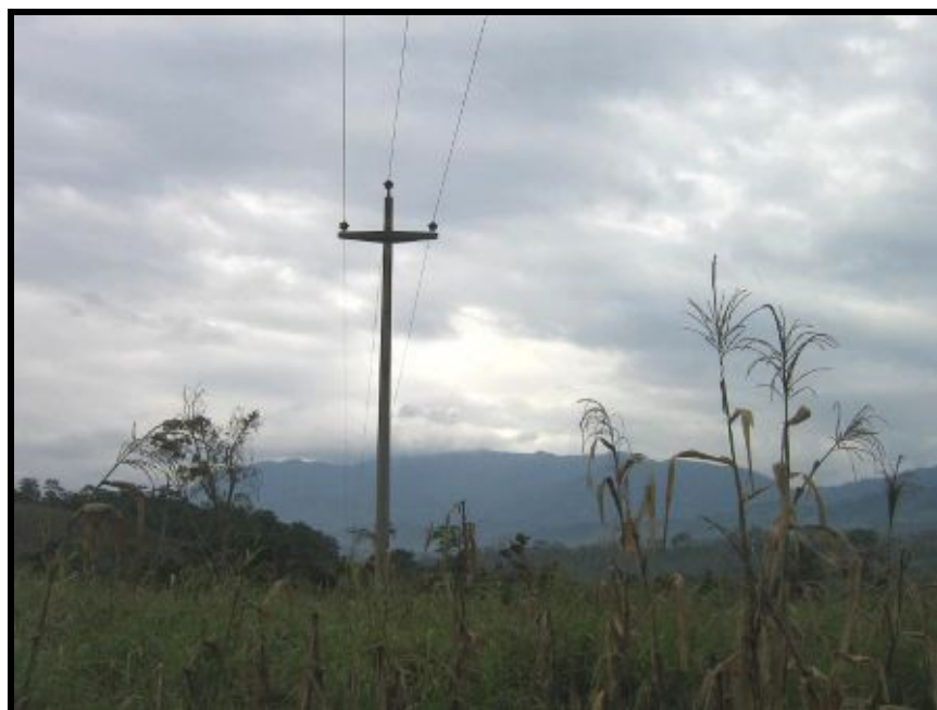
Foto 2 LT 22.9kV SE Bellavista – San José de Sisa.
